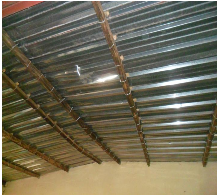
Vues de l'intérieur du réfectoire ; les parties blanches sont les déchirures des tôles qui sont irrécupérables
