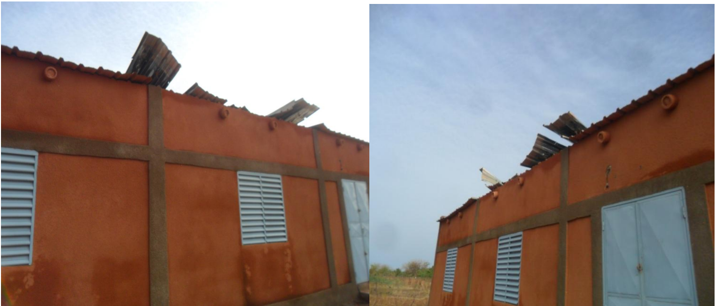
Vue latérale des dégâts à la toiture du réfectoire et ci-dessous depuis l'intérieur
