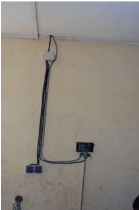
Régulateur, boîte de dérivation et interrupteurs dans un dortoir.
