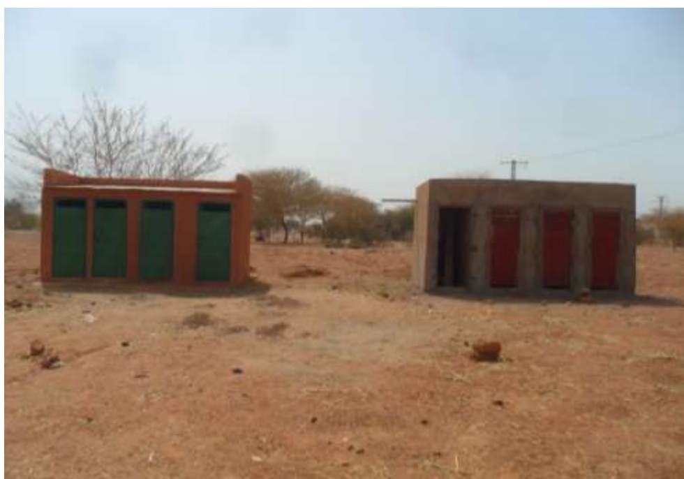
Une porte doit encore être posée sur le bloc de droite en cours de finition
