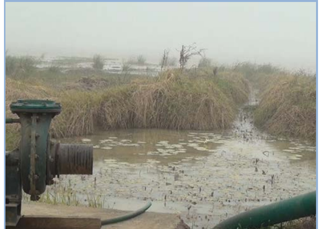
Le canal de prise d'eau des pompes des maraîchages doit être remis en état.
